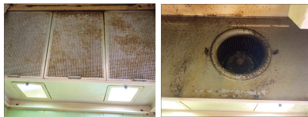
レンジフード内部ファン：油汚れ
