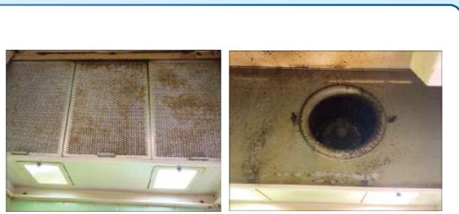
レンジフード内部ファン：油汚れ
